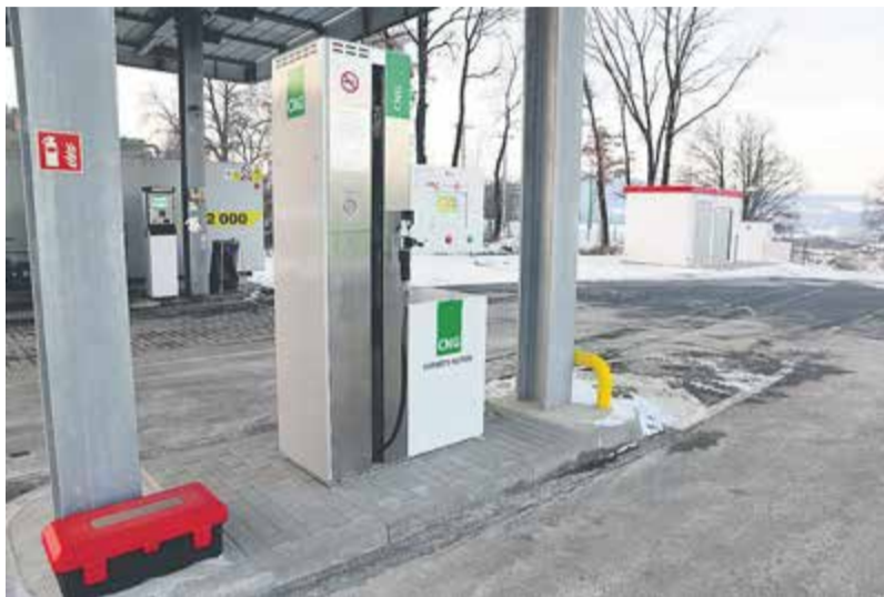
Motoristům je u nové plnicí stanice na Prachaticku k dispozici oboustranný stojan vybavený koncovkami NGV1 pro osobní a užitkové automobily.
