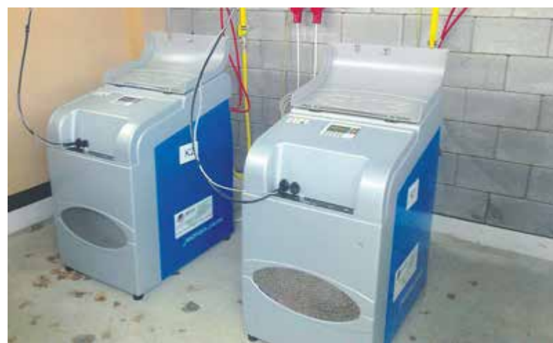
Srdcem stanice jsou dva kompresory MJ Compact 05 s výkonem deset metrů krychlových za hodinu.
