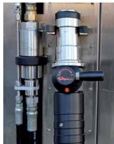
Detail výdejního stojanu plnicí CNG stanice
