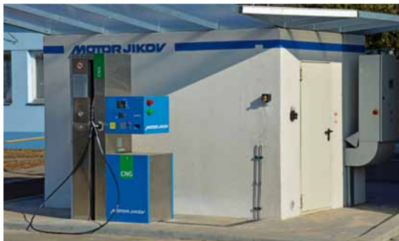
Stanice MJ Variant Plus funguje v dolním areálu firmy v Kněžskodvorské ulici.
