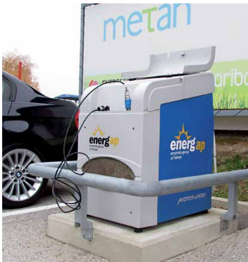
Jedna z instalací plnicí jednotky MJ Compact 05 ve Slovinsku
