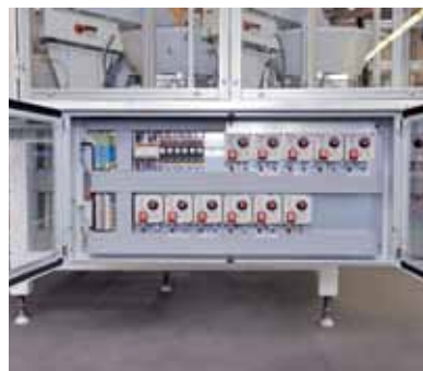
Ukázka konstrukčního hi-tech provedení rozvaděče z dílny divize Jednoučelové stroje společnosti MOTOR JIKOV Fostron a.s. Rozvaděče jako nedílná součást elektroinstalací vykonávají celou řadu operací. Zákazníci oceňují nejvyšší technickou úroveň, kvalitu a moderní design.
